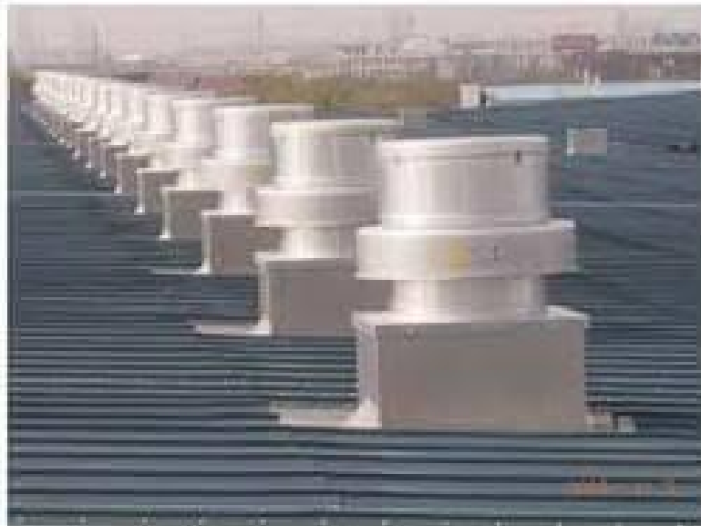
ROOF TOP FAN
